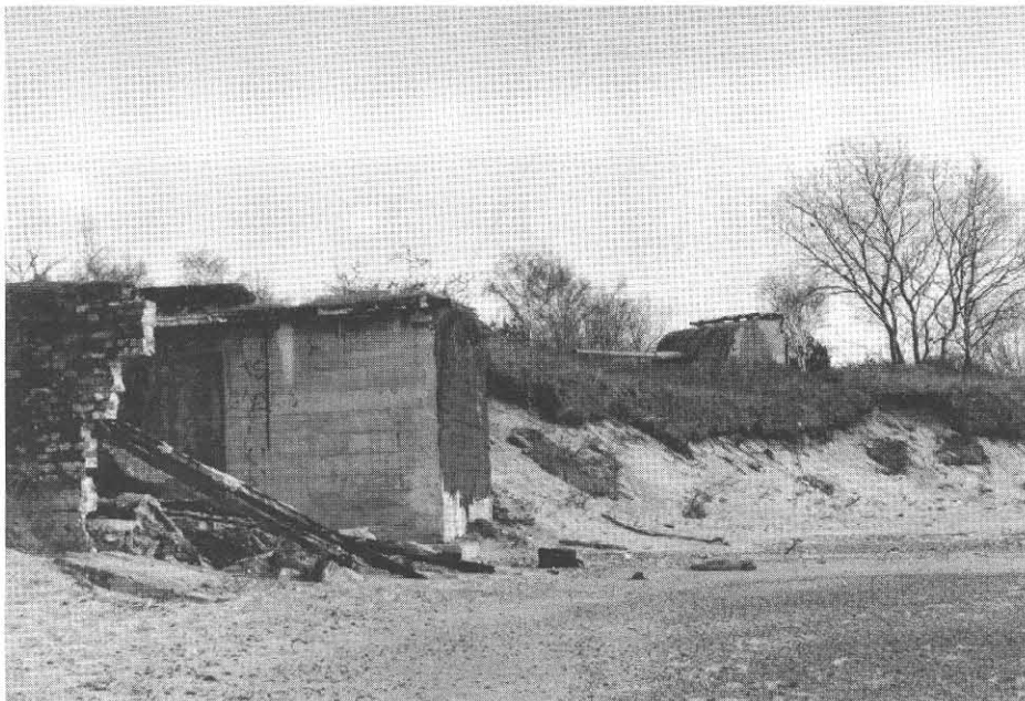
Powyżej: podmyty przez fale morskie schron amunicyjny, znajdujący się na końcu prawego skrzydła podziemnych korytarzy (patrz mapa w cz. I, zamieszczonej w „Fortecy” nr 11) – stan 01.2003 r. Poniżej wejście do schronu centrali artyleryjskiej. Fot. W. Nadolny.
