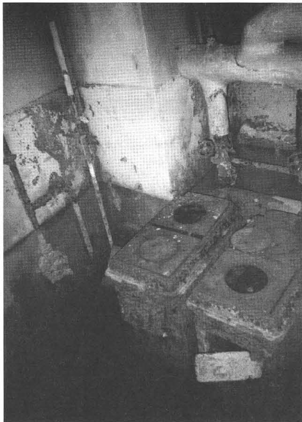
Centrala artyleryjska. Powyżej kotłownia C.O. Poniżej urządzenia wentylacyjne.
